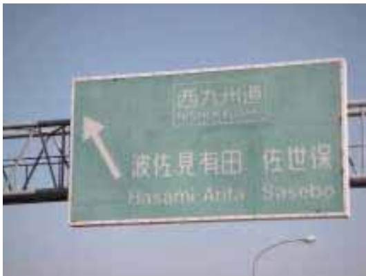
施工前 (劣化したアクリル板)
