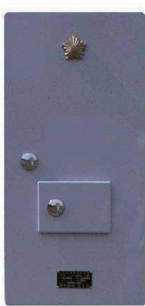
U形交通信号制御機fi
